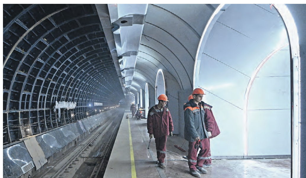
5 октября 15:53 Станция «Рижская» БКЛ строится по конкурсному проекту. На станции появятся светящиеся порталы. Они уже смонтированы
