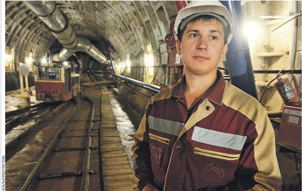
25 июля 12:27 Горный мастер Артем Шукин в начале тоннеля, ведущего к будущей станции Большой кольцевой линии Московского метрополитена «Марьино Рошча»
