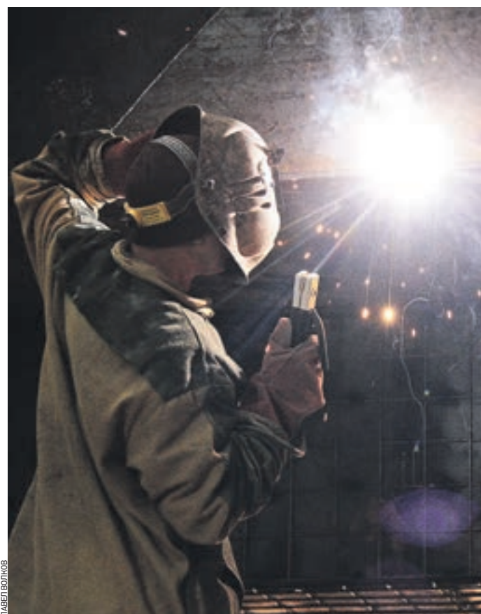
6 августа 2016 года 11:13 Станция «Фонвизинская». Метростроитель проводит сварку деталей. Работы проходят на глубине более 60 метров
