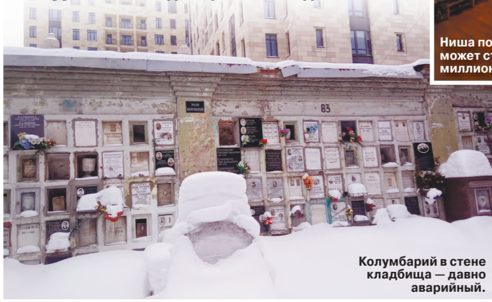
Колумбарий в стене кладбища — давно аварийный.
