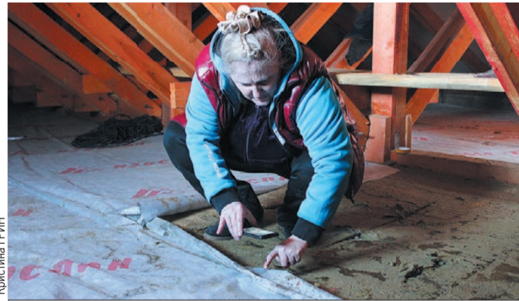
Оказалось, что крыша течет из-за того, что строители положили изоляцию не той стороной.
