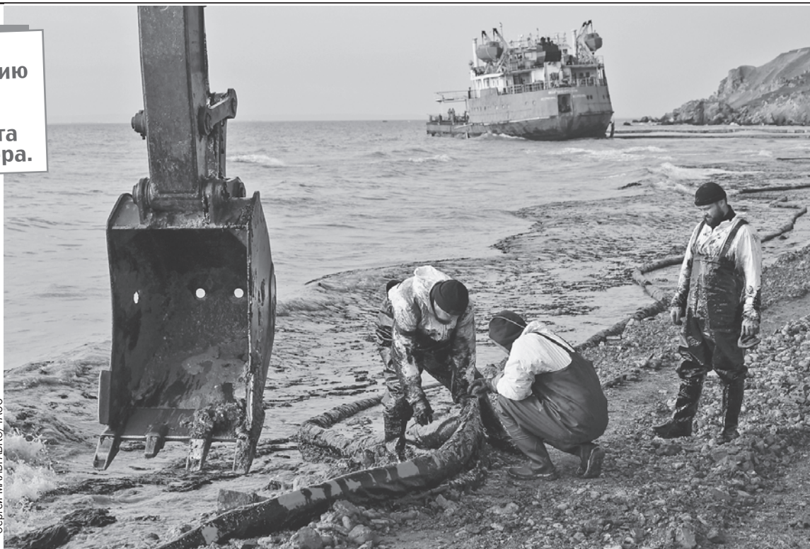
На месте нового разлива работает и тяжелая техника, и ручную мазут тоже собирают.
