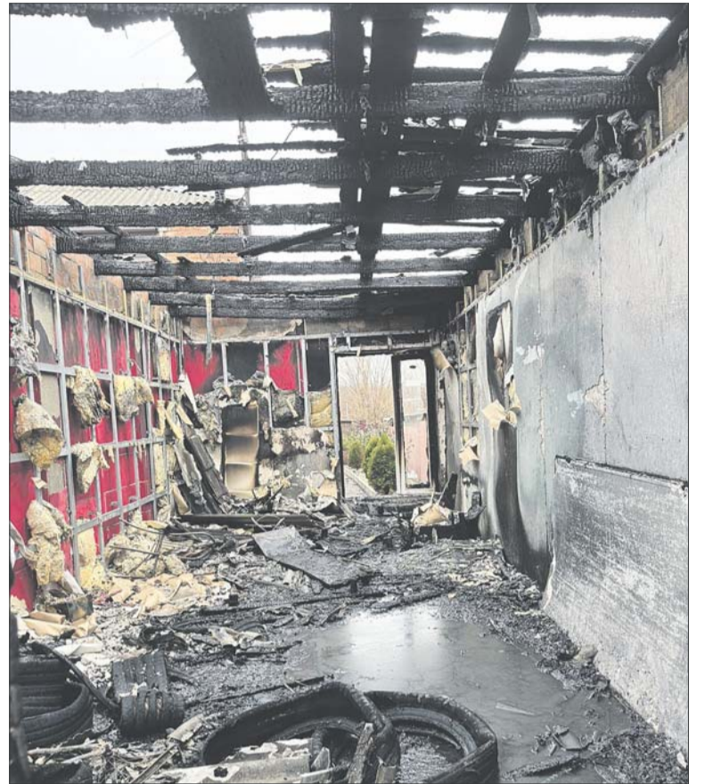
Огонь полностью уничтожил гараж и перекинулся на дом.
